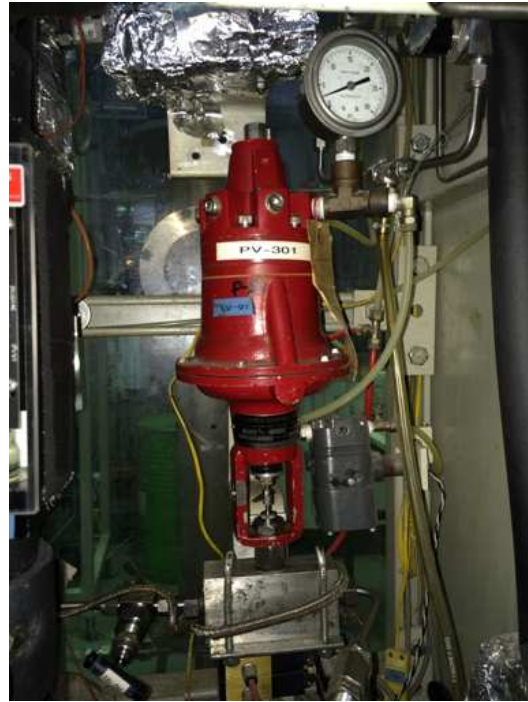
Εικόνα 7.9. Βάνα που ελέγχει τη ροή εισόδου στη δεξαμενή
